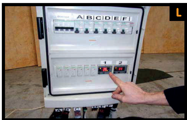
L. Impostare il setpoint per la temperatura desiderata.
