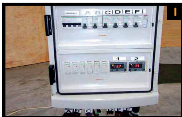
I. Collegare le prolunghe per l'alimentazione elettrica e quelle relative alle sonde di temperatura al quadro elettrico corrispondente.
